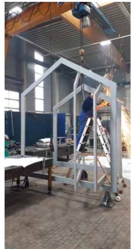
Aus einer einzigen Platte Stahl entstand in der Werkstatt der Brunnen samt Wasserschale.
